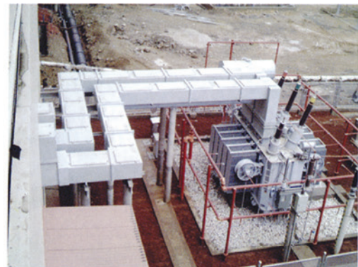
启备变回路共箱母线
