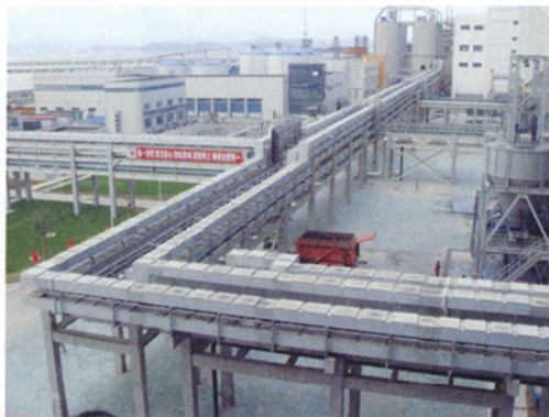
电厂共箱母线应用
